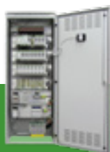
Centrale batterijsystemen en decentrale monitoringsystemen
