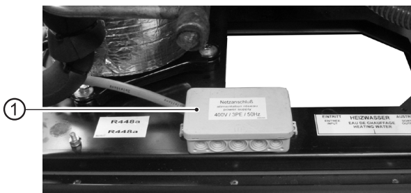
1 Elektrische aansluitdoos: Netaansluiting van de warmtepomp
