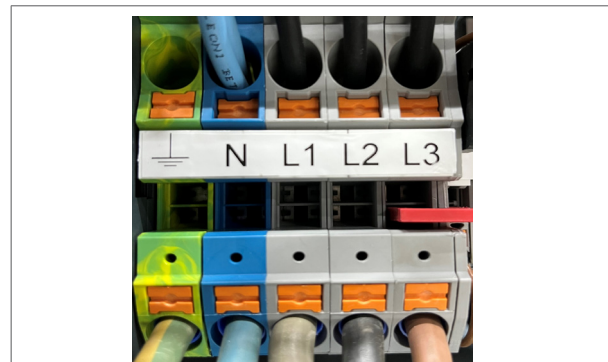
Figuur 7 - De verbindingsklemmen van de luchtverwarmer
