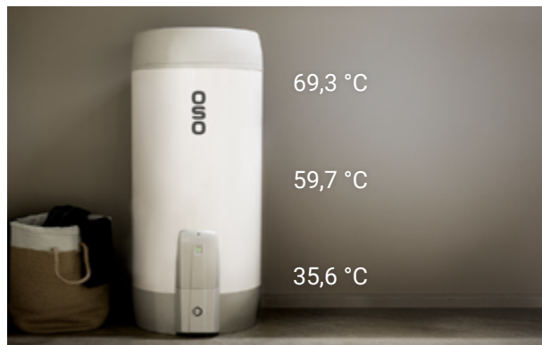
Afbeelding 1. Drie meetpunten in de boiler.
