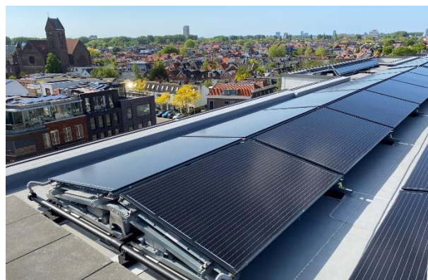
Voorbeeld van een platdakopstelling op een appartementencomplex in Delft.
