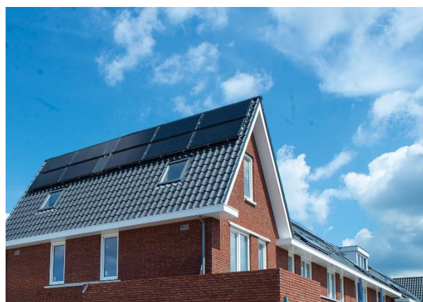
Voorbeeld van een schuindakopstelling op een woonblok in Ridderkerk.
