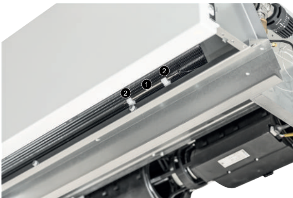
Abb. 20: Fernfühler ① und Rohrclipse ② montiert.
