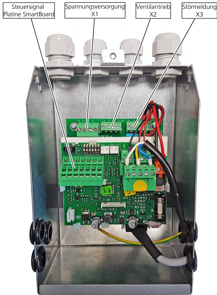
Abb. 27: Platine im Elektroanschlusskasten
