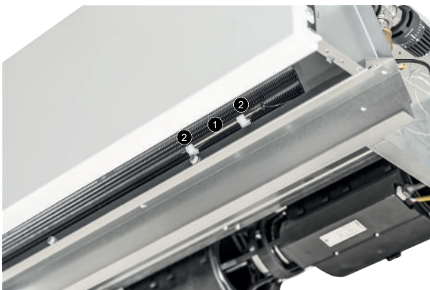
Abb. 20: Fernfühler ① und Rohrclipse ② montiert.
