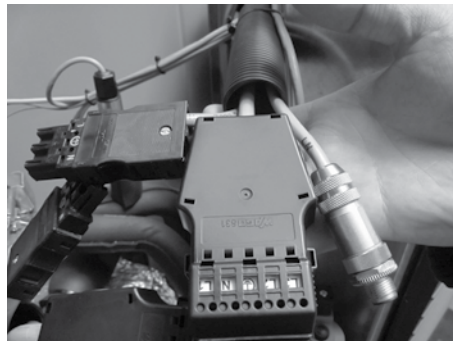
Aangesloten leidingen in het buitenapparaat.
