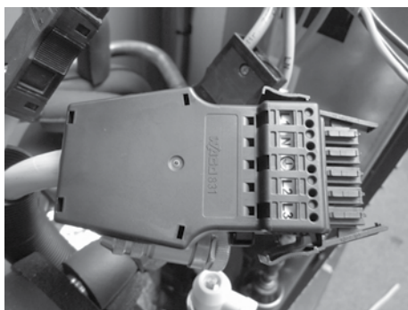
Aangesloten stekkers voor stroom- en regelleiding.
