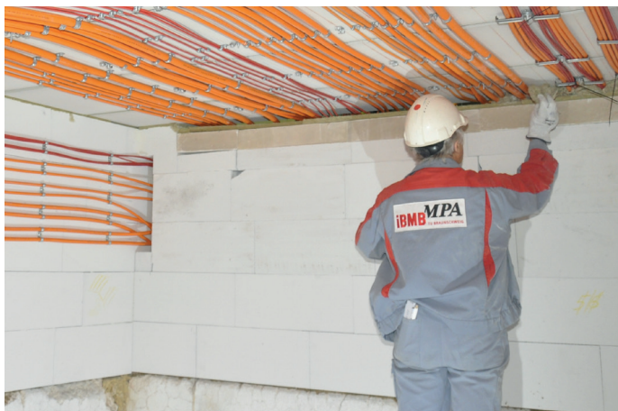
Installatie van de JMV beugels plus kabels in de testruimte van iBM.
